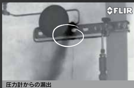
圧力計からの漏出
